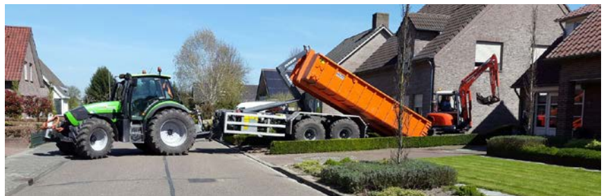
Voor het regelen van de aan- en afvoer van diverse grondstoffen bevat de haakarmcarrier prima. Binnenkort komt er een nieuwe trekker met bumper voor veiliger rijden op de weg.
